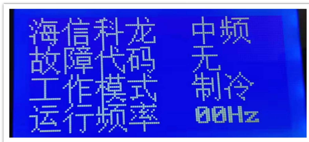
图 7、正常运行显示界面
